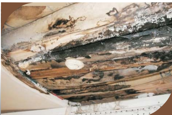
Vigas afectadas por hongos de pudrición blanda
