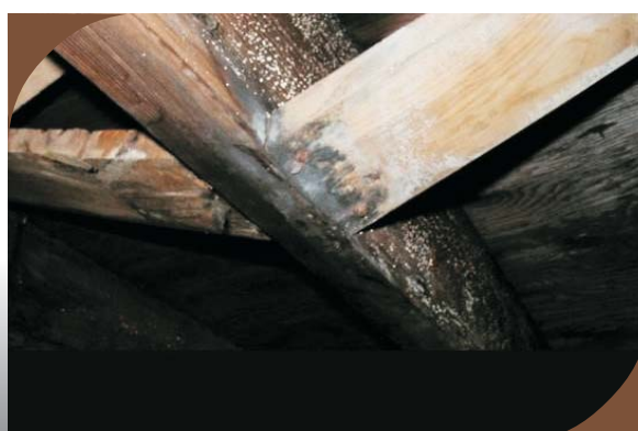
Vigas atacadas por hongos de pudrición parda
